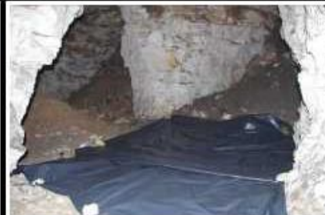
Photographie K-48 : Ciel dégradé à proximité des catiches P676 et P677, après mise en place de la bâche (Photo 2977)
