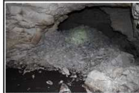
Photographie L-12 : Nombreux blocs tombés au sol au droit de MV101 (Photo 2960)
