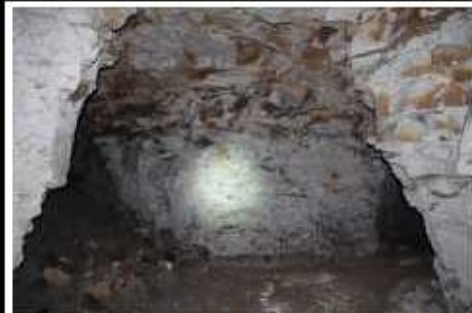
Photographie K-47 : Ciel dégradé à proximité des catiches P676 et P677, avant mise en place de la bâche (Photo 2974)
