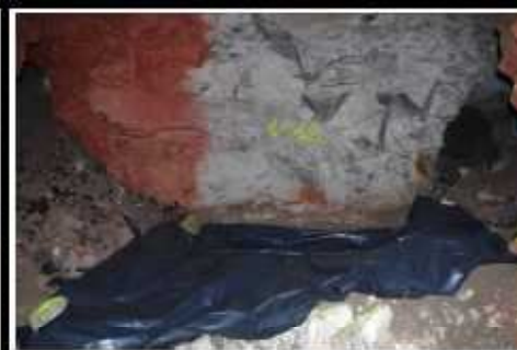
Photographie K-46 : Chute de ciel à proximité des catiches P667 et P670, après mise en place de la bâche (Photo 2979)
