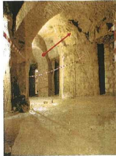
Masse en ciel instable avant confortement
