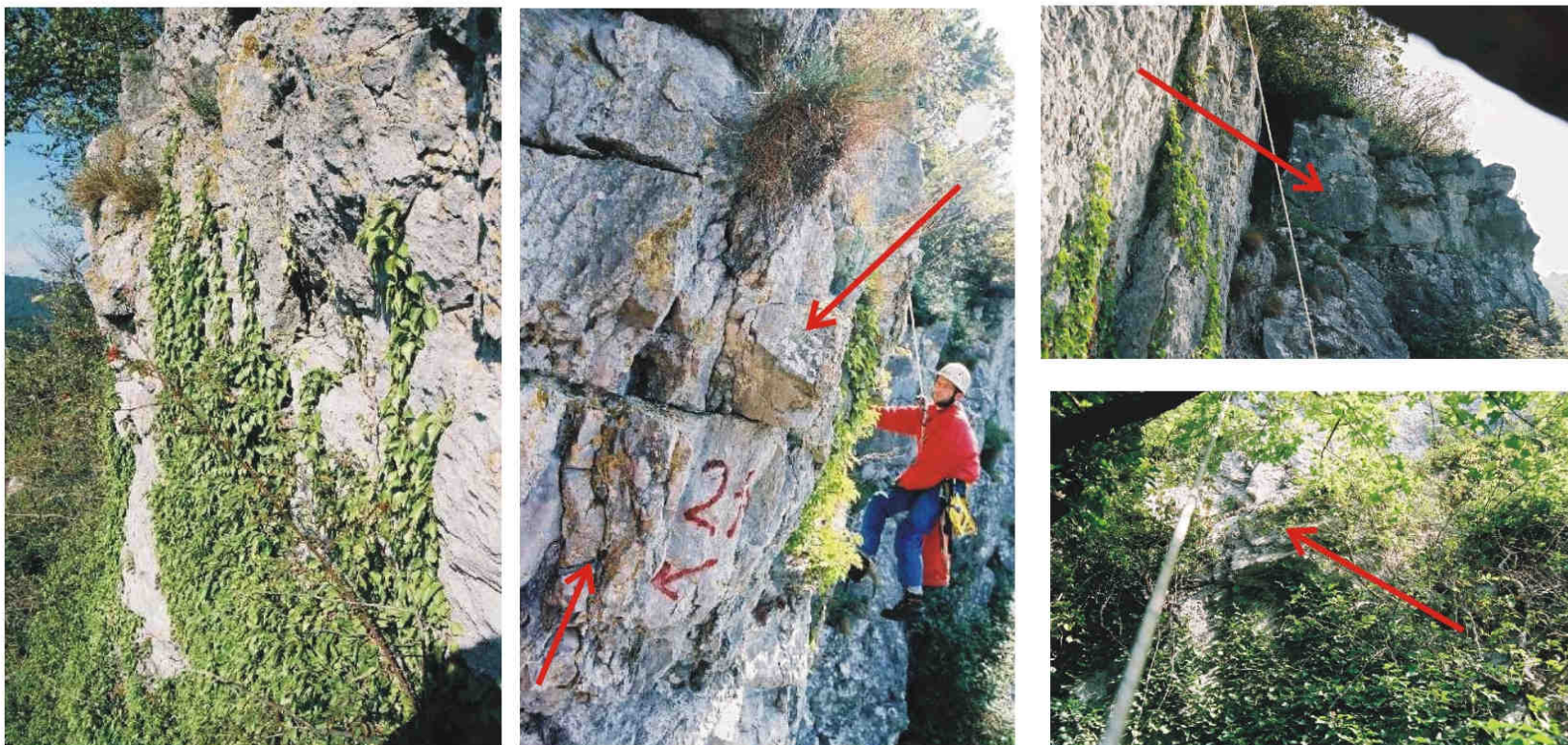
A1-33, 34, 35, 36 - Ensemble C21 - Détails de la fracturation du massif. Protection générale par dispositifs pare-blocs mis en place dans le versant
