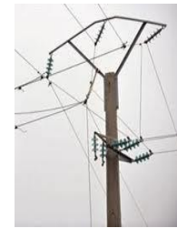
Raccordement au réseau ERDF
