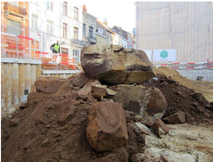
Concrétions ferrugineuses sur chantier Boondael
