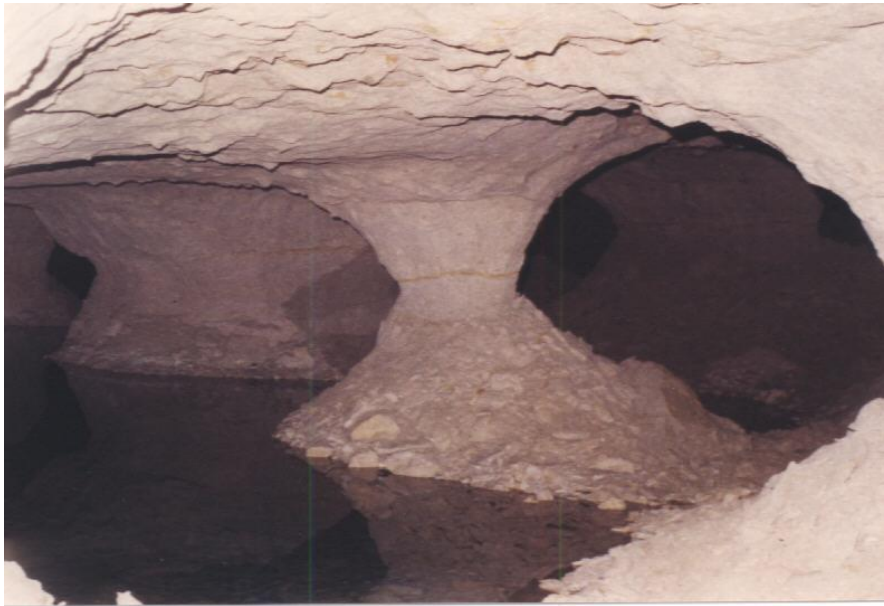
Exemple de pilier écaillé dans les carrières souterraines de la Malogne.
