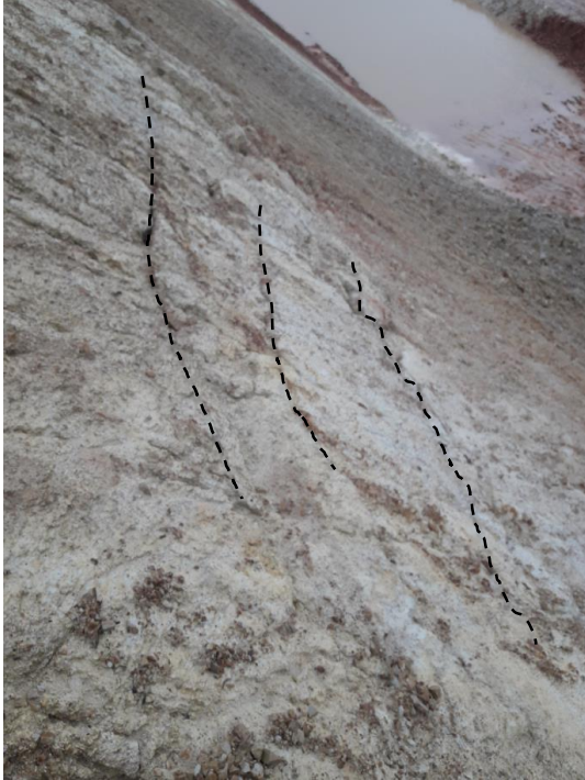
Fissures et bourrelets dans la pente
