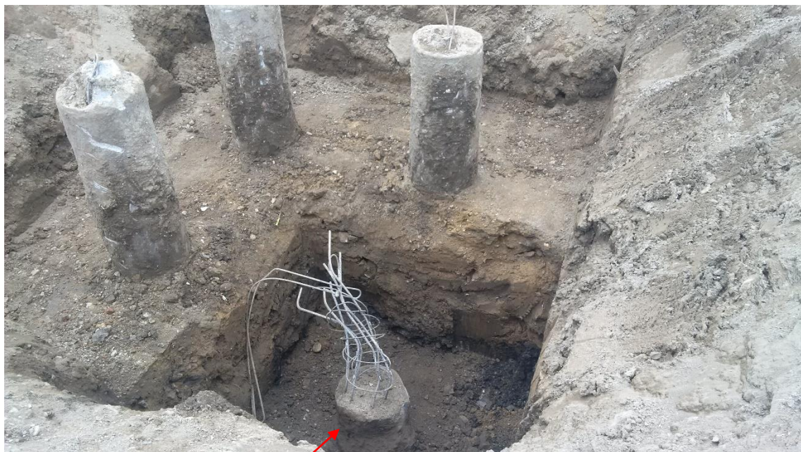
Une partie du béton a été perdue pendant le bétonnage dans une cavité
